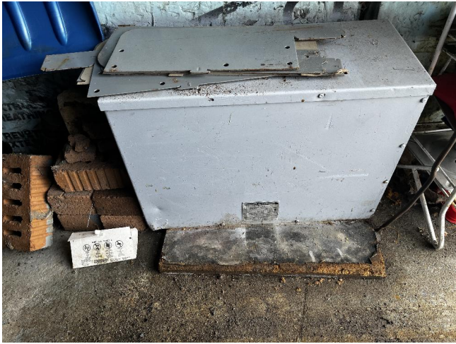
Transformador Square D de 15 kva
