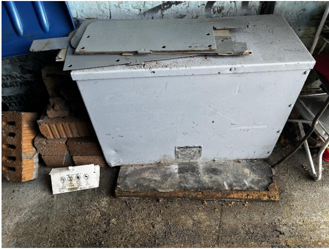
Transformador Square D de 15 kva
