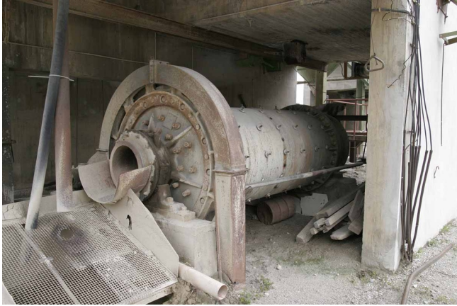
Molino de Bara Krupp de 1.25 mts dia x 3.0 mts (Stabrohmühle)
