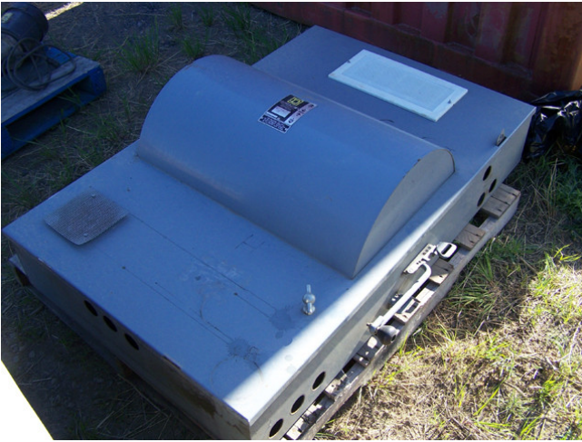
600 Volt 600 Amp 250 HP Square D Transfer Switch
